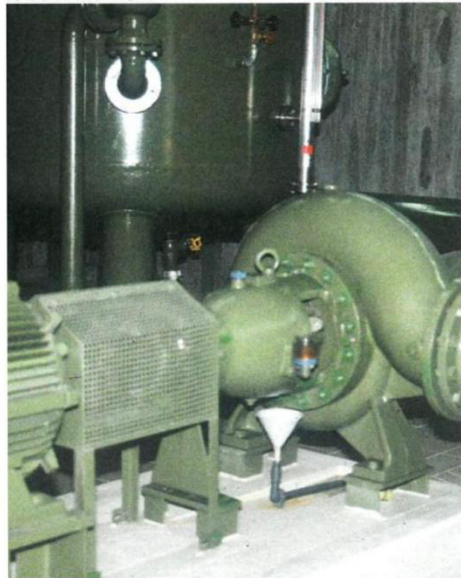
„rückwärtslaufende Kreiselpumpe „Hasenberg“
